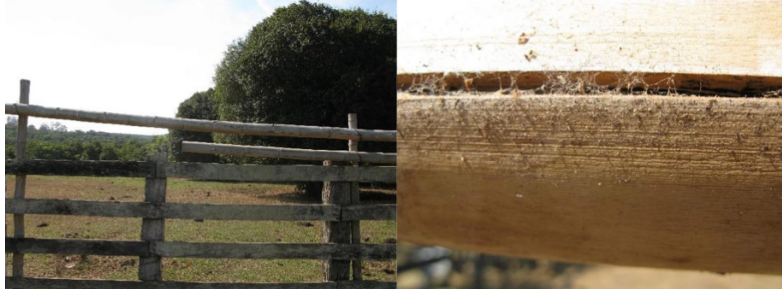
Figura 06: Bambu exposto às intempéries. Detalhe de uma rachadura no colmo.
