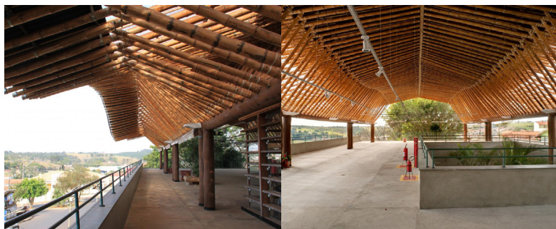
Figura 19: Detalhes da mão-francesas e união dos colmos de bambu a estrutura de madeira. Fonte: Amima, 2018.
